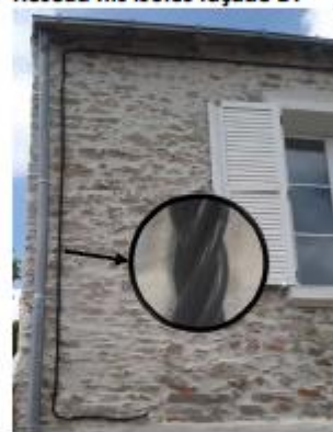
Réseau fils isolés façade BT
