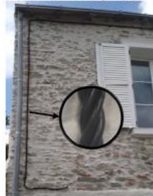
Réseau fils isolés façade BT
