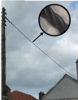
Réseau fils isolés aérien BT
