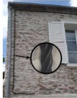
Réseau fils isolés façade BT
