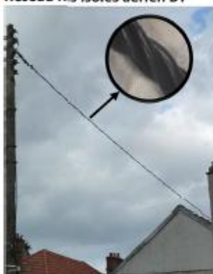
Réseau fils isolés aérien BT
