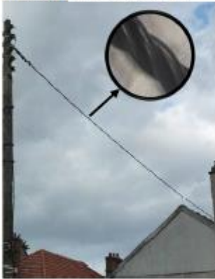
Réseau fils isolés aérien BT
